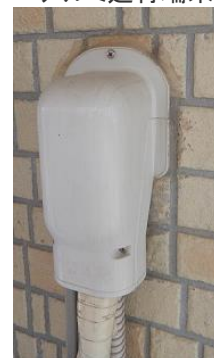
エアコンホースカバー周り
